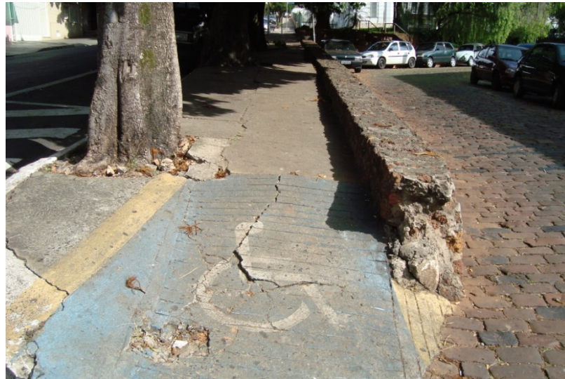
Figura 6 – rampa em desacordo com NBR 9050
