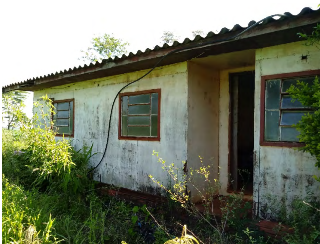
Figura 20 – Registro fotográfico da fachada externa do antigo posto de saúde na Área 10
