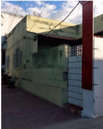
Figura 23: Foto do “Castelo de Pau dos Ferros”, após a “reforma”, completamente descaracterizado
